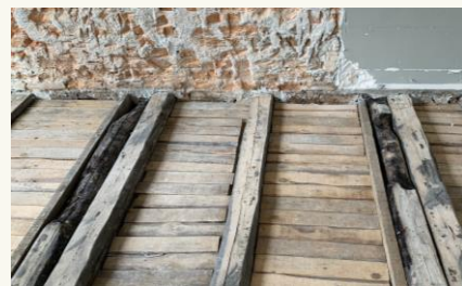
Brændte bjælker i etageadskillelsen i sidebygningen fra en brand vi ikke kender årstallet på
